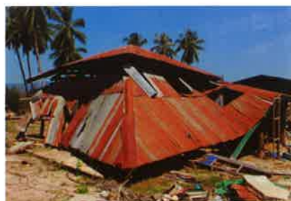
浸水によって崩れた家屋
